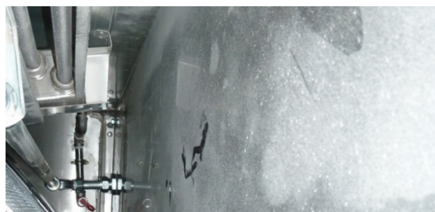
Beeld van een afzuigplenum uitgerust met UV-C-lampen na werking gedurende verscheidene weken.
